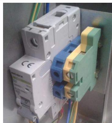
Рисунок 12– Подключение кабеля питания
